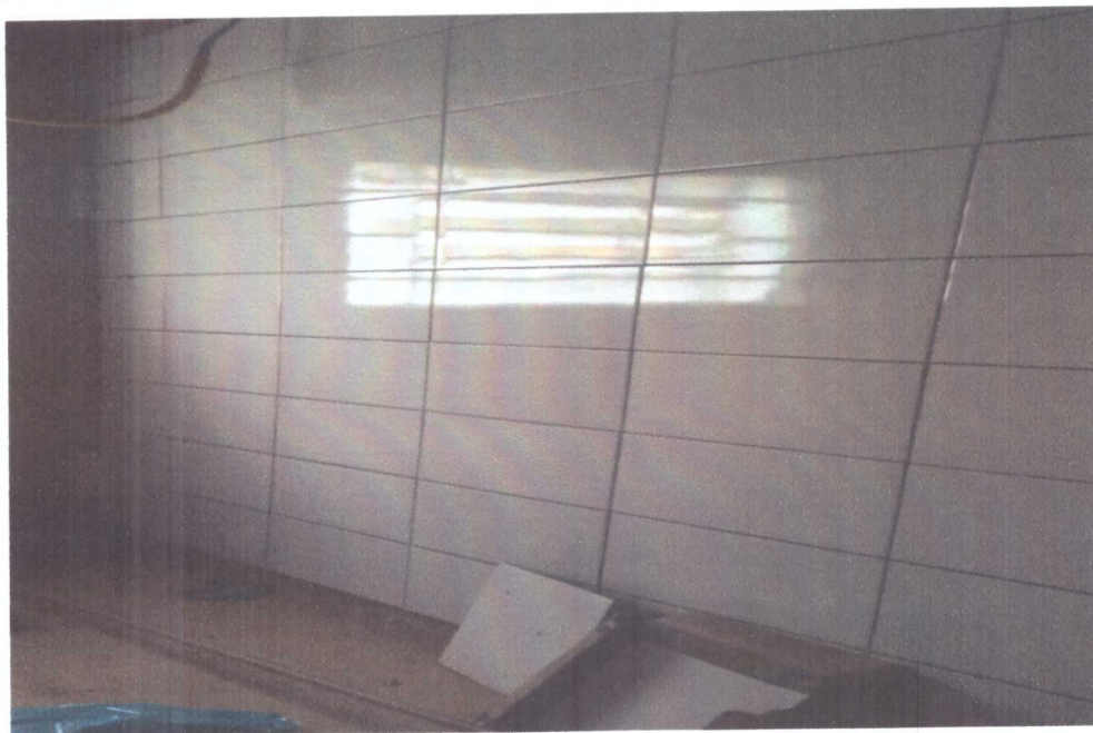
ASENTAMENTO DE REVESTIMENTO DE PAREDE
